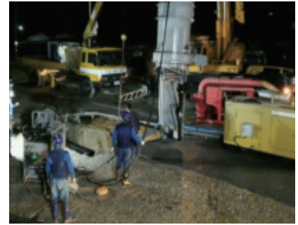
2017년 여수 도수관로 파손사고 6만 1000천가구 단수 발생
