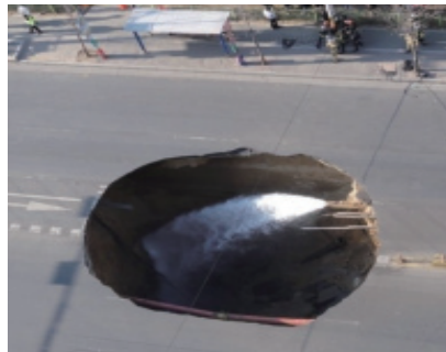
2012년 인천 싱크홀 사고 오토바이 운전자 1명 사망
