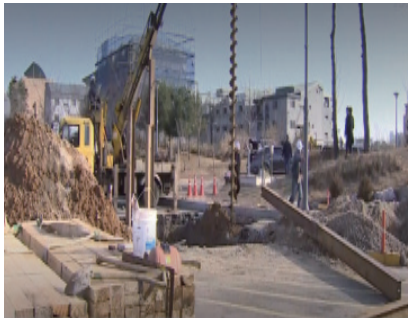
2018년 파주 고압전선 파손 사고 1600여가구 전력 공급 중단
