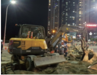
2018년 해운대 마린시티 도시가스관 파손 사고 4500여가구 난방 및 가스공급 중단
